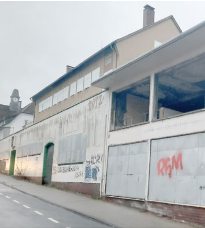
Schandfleck am Eingang zur Altstadt: Das leerstehende ehemalige Möbelhaus am Lenneper Bahnhof beschäftigt die Bezirksvertretung seit Jahren.
