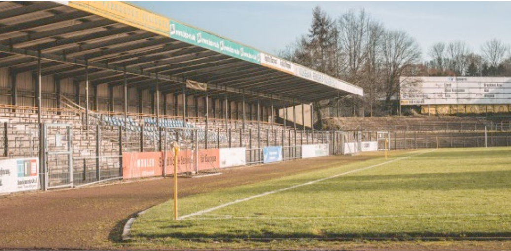
Das Röntgenstadion in Lennep bleibt ab sofort geschlossen. Die Stadt Remscheid sieht aufgrund massiver Bauschäden keine Möglichkeit mehr für einen sicheren Betrieb. Foto: FC Remscheid
