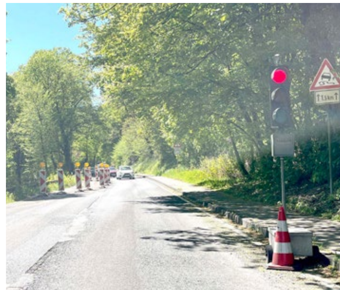
Die Baustellenampel an der Ronsdorfer Straße zwischen Birdgen und Halbach – seit Mai 2025 regelt sie den Verkehr an der abgesackten Fahrbahn. In den Sommerferien 2026 sollen die Sanierungsarbeiten endlich beginnen. Foto: LLA
