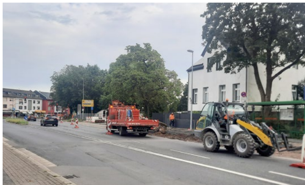
Am Eisenstein laufen vorbereitende Arbeiten, bis es dann Mitte August mit dem Umbau der Kreuzung in einen Kreisverkehr richtig losgeht.
