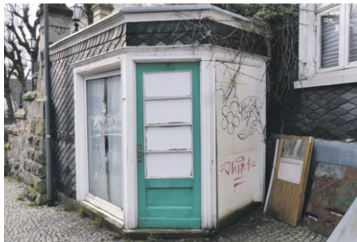
Wann wird aus der Bretter- endgültig eine Bruchbude?
