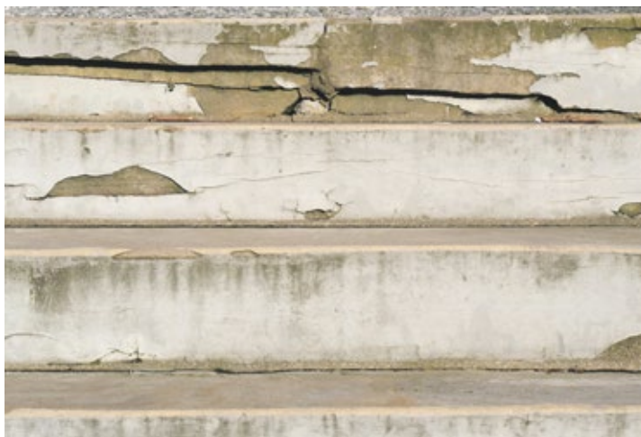
Küster Jürgen Kammin weiß um die Sanierungsbedürftigkeit der Treppe, die zum Kirchportal hinaufführt.
