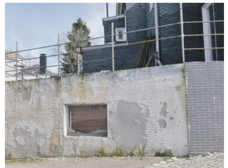
Abblätternde Farbe im Eingangsbereich.
