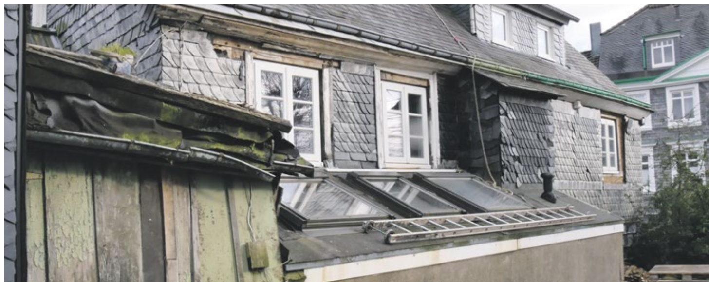
In der Nähe des restaurierten Kriegermahnmals stößt der Fußgänger auf dieses verfallende Hinterhaus. Fotos (4): TSAI Thomas Schulte
